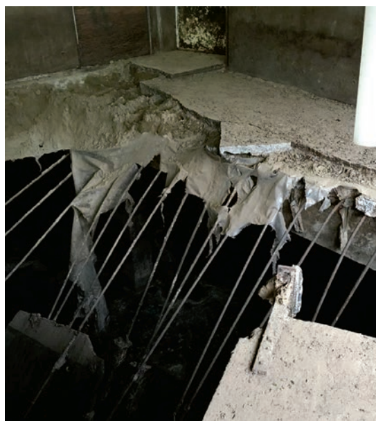
Le trou a de quoi surprendre comme on peut le constater sur les photos. On peut y voir les tiges d'acier qui ont permis à René Leblanc de s'agripper et lui éviter un plongeon tête première.
