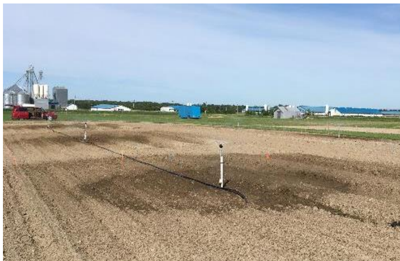
Figure 1 Installation du système d'irrigation par aspersion dans le dispositif de carotte.
