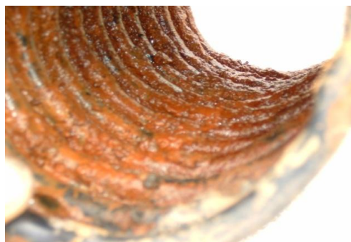
Figure 10 : Un exemple d'une section de collecteur découvert, démontrant le colmatage par l'oxyde de fer, qui obstrue énormément les trous dans le drain, empêchant l'eau d'entrer.
