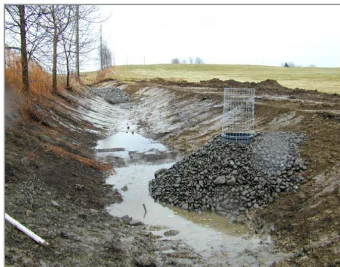
Grille aménagée sur un puisard
