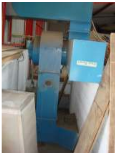
Détails des équipements d'une chambre de séchage
